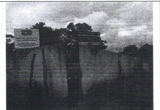
Reservatório Santa Quitéria Localizado: Rua da Saudade S/n Bairro Santa Quitéria
