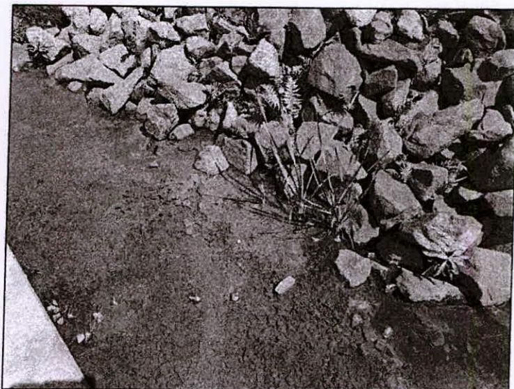
Foto 38 – Presença de colóides na saída do dreno de fundo MV-B4-01.
