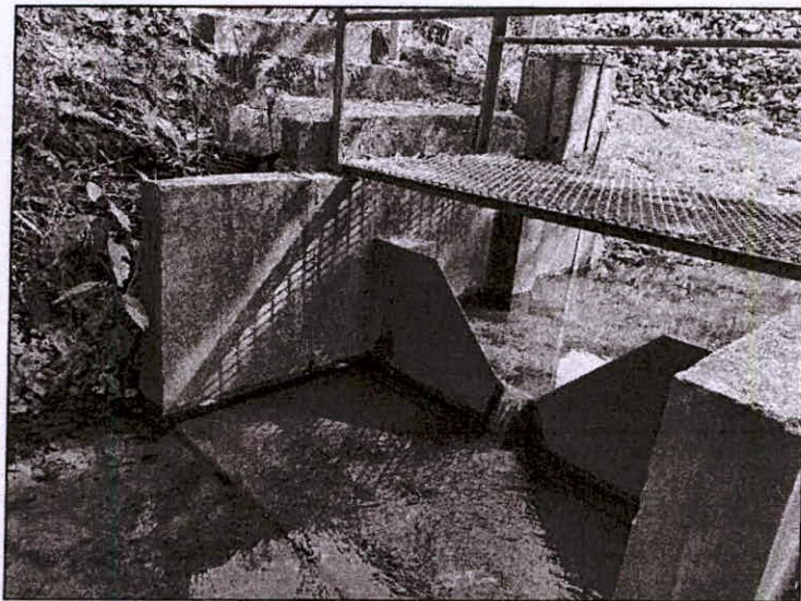
Foto 13 – Medidor de vazão de chapa triangular na saída do dreno de fundo.
