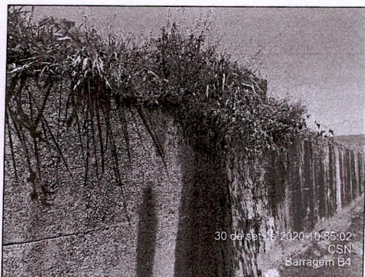
Foto 42 – Surgência observada na parede esquerda do canal extravasador, provenientes do terreno natural.
