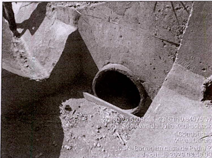
Foto 22 – Caixa de passagem com assoreamento e pedaço de madeira no emboque do bueiro. Barragem Casa de Pedra.
