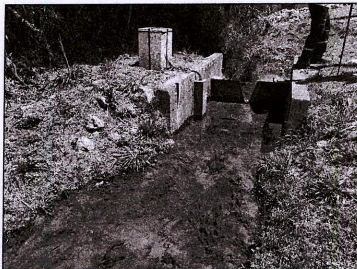
Foto 69 – Medidor de vazão em chapa triangular na saída do dreno de fundo.
