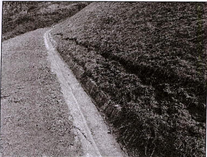
Foto 10 – Presença de feições horizontais próximo às canaletas de drenagem de berma.
