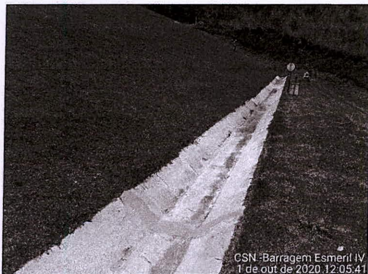
Foto 75 – Canaleta de drenagem com trinca tratada.
