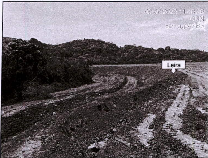
Foto 50 – Vista de leira contornando o reservatório (sem proteção vegetal), cuja drenagem é conduzida para o acesso e para o canal de cintura, na margem esquerda.
