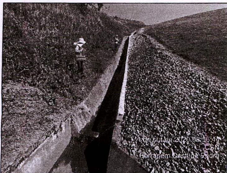
Foto 23 – Vista da descida d'água, na ombreira direita do maciço, onde observaram-se algumas surgências.
