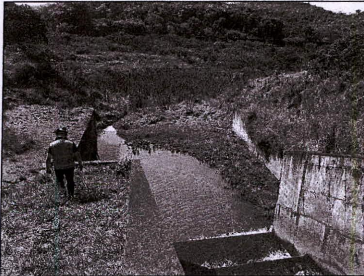
Foto 18 – Bacia de dissipação e canal de restituição assoreados e com vegetação.
