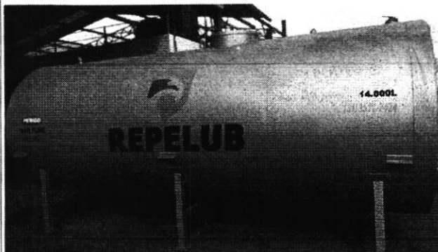
Foto 01: Vista geral do equipamento
