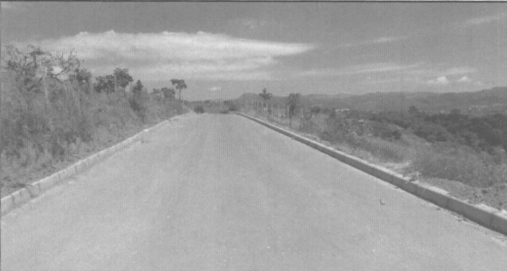
EXECUÇÃO / ASSENTAMENTO DE MEIO FIO COM CONFINAMENTO EM CONCRETO - ÁGUA BOA (RUA 08)
