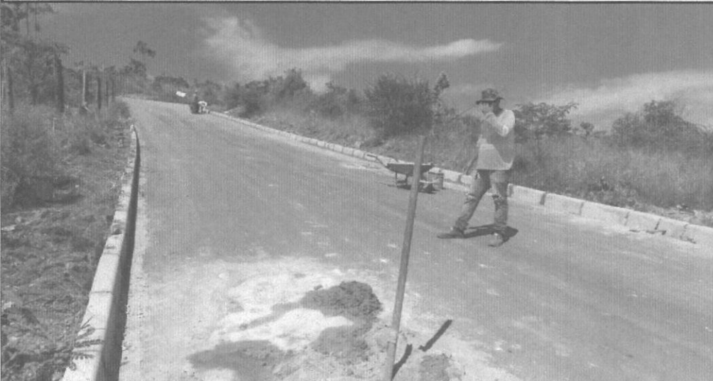
EXECUÇÃO / ASSENTAMENTO DE MEIO FIO COM CONFINAMENTO EM CONCRETO - ÁGUA BOA (RUA 08)
