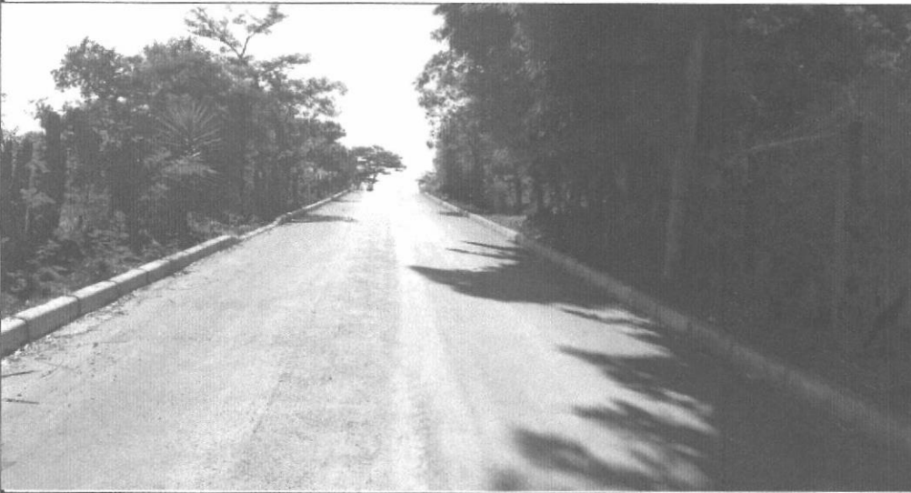
EXECUÇÃO / ASSENTAMENTO DE MEIO FIO COM CONFINAMENTO EM CONCRETO - ÁGUA BOA (RUA 1)
