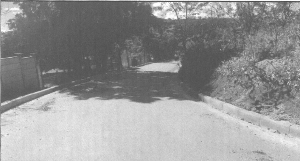
EXECUÇÃO / ASSENTAMENTO DE MEIO FIO COM CONFINAMENTO EM CONCRETO - ÁGUA BOA (RUA 8)
