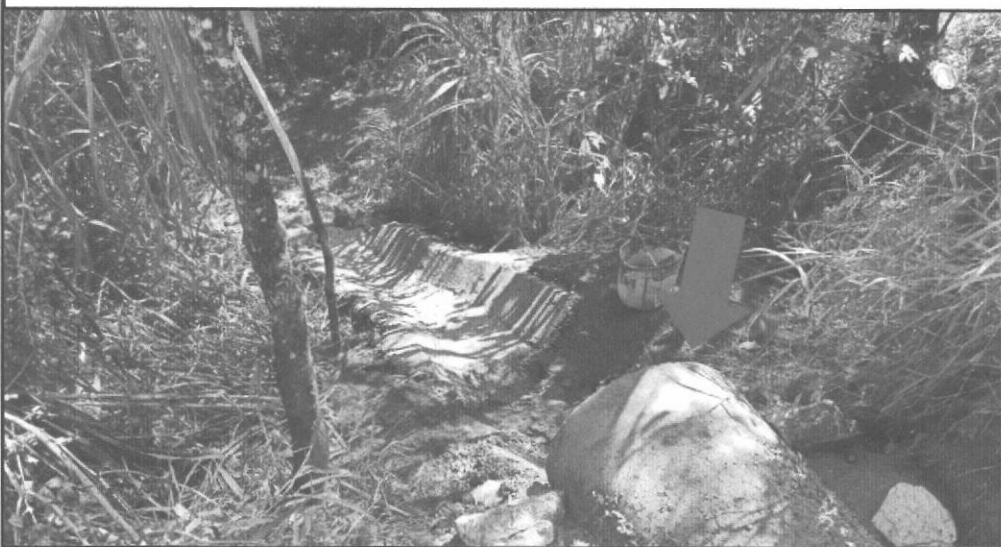
REDE DE Ø600mm (próximo a ponte, BL dupla) - ÁGUA BOA (RUA 10)
