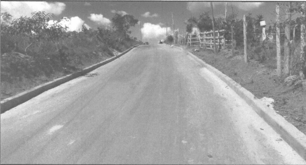
EXECUÇÃO / ASSENTAMENTO DE MEIO FIO COM CONFINAMENTO EM CONCRETO - ÁGUA BOA (RUA 6)
